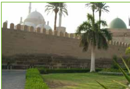
Ein Beispiel für aufsteigende Feuchtigkeit
