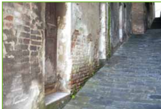
Zerstörung des Putzes und der Mörtelfugen
