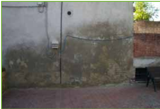
Veränderung der Farbe, Reduzierung der Wärmedämmung
