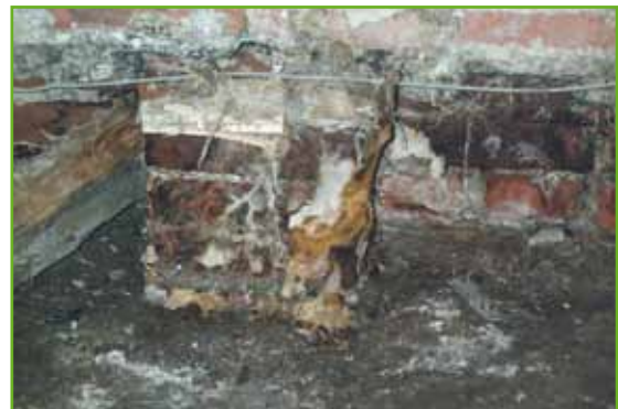
Entwicklung von Schimmel, Pilzen und Schädigung der Bausubstanz
